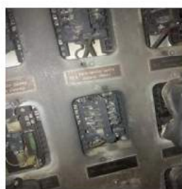
releul auxiliar de protecție – poziția 76
