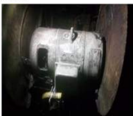
motor electric ventilat forțat postul 1
